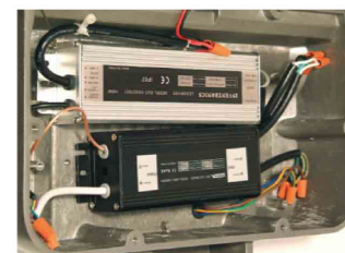
AC voltage input
